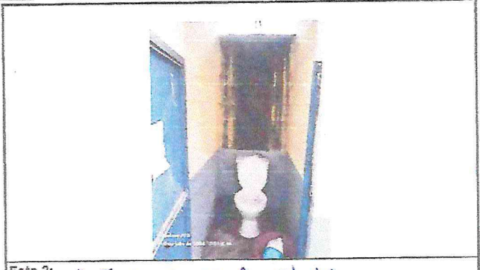
Foto 2: Baños en mal estado
